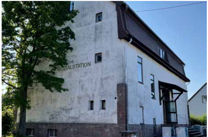
Ehem. Sozialstation im Kreuzungsbereich Wilhelmstraße/Johannesstraße mit Sanierungsstau
