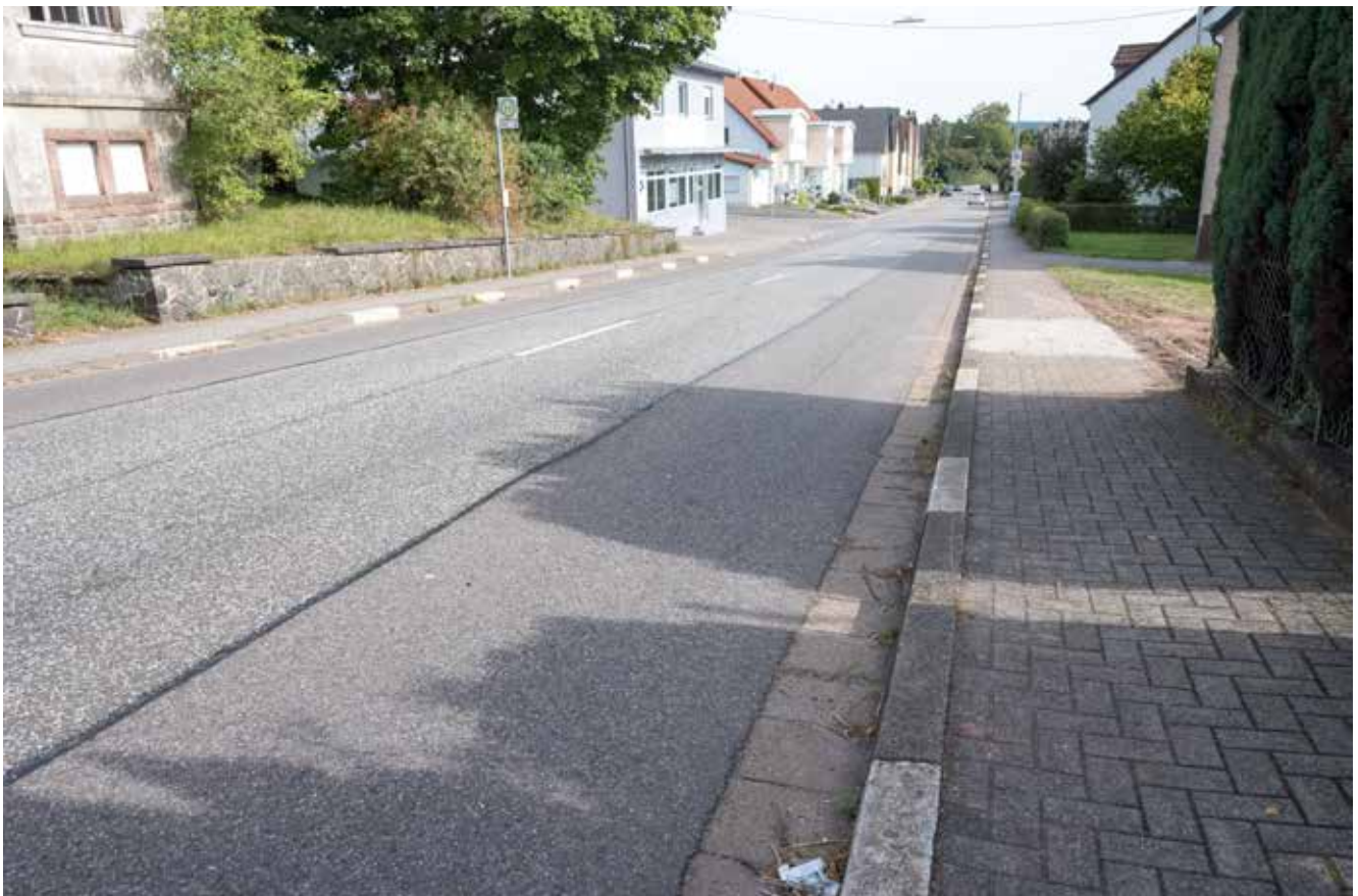
Ortsdurchfahrt „Saarbrücker Straße“ (L 141) im nördlichen Bereich mit Sanierungsbedarf
