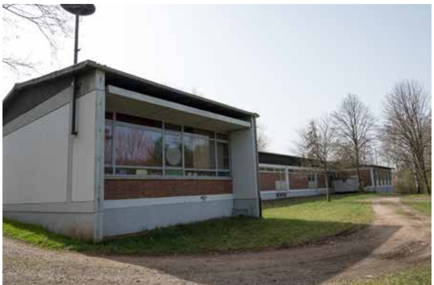
Mindergenutzte und stark sanierungsbedürftige ehem. Grundschule (Rückansicht)
