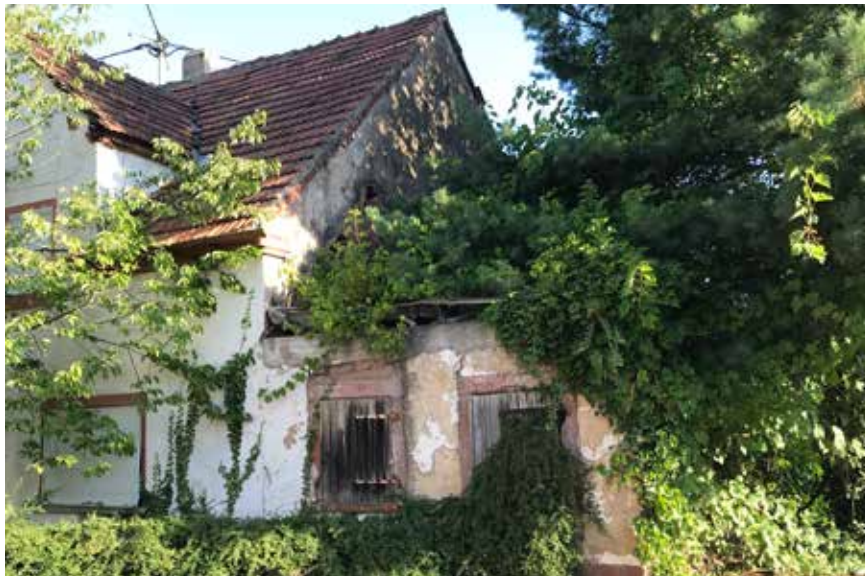
Leer stehendes Wohngebäude mit hohem Sanierungsbedarf im Bereich Jungwaldstraße/ Kupferne Hölle
