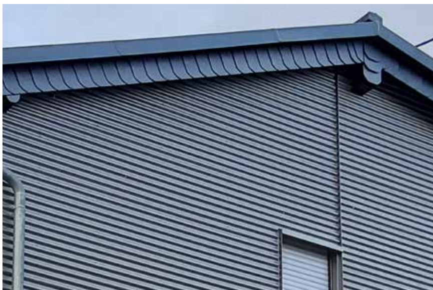
Gestalterische Missstände, z.B. Materialität der Fassaden
